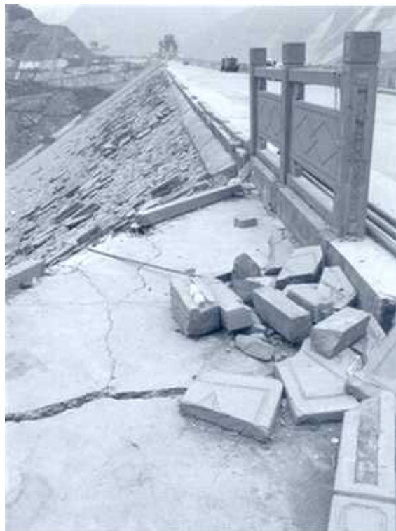
Đập Tứ Bình Phò bị nứt trong trận động đất ở Tứ Xuyên
